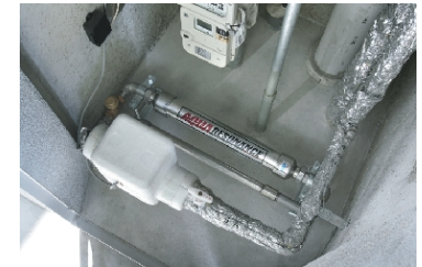
■マンション設置例
